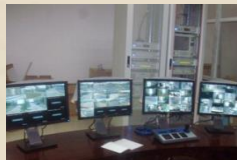
公安局监控室
